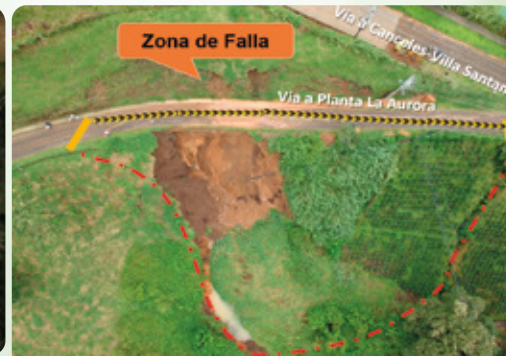
Daño vía a la Planta de Tratamiento sector Canceles
