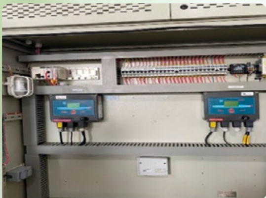
Optimización del sistema de tratamiento y distribución de agua potable
